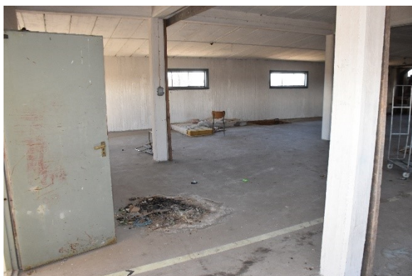
Figur 5. Bild som visar del av plan 3, del 2. Rester från en mindre brandhärd finns till höger om dörren. Det är okänt om denna brandhärd är från det aktuella brandtillfället.
