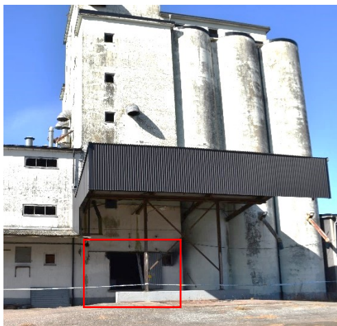
Figur 7. Bild på den del av byggnaden där branden samt arbetsplatsolyckan skett. Lastbryggan som utgjort angreppsväg till utrymmet som brunnit i bottenplan är markerad med röd ram.
