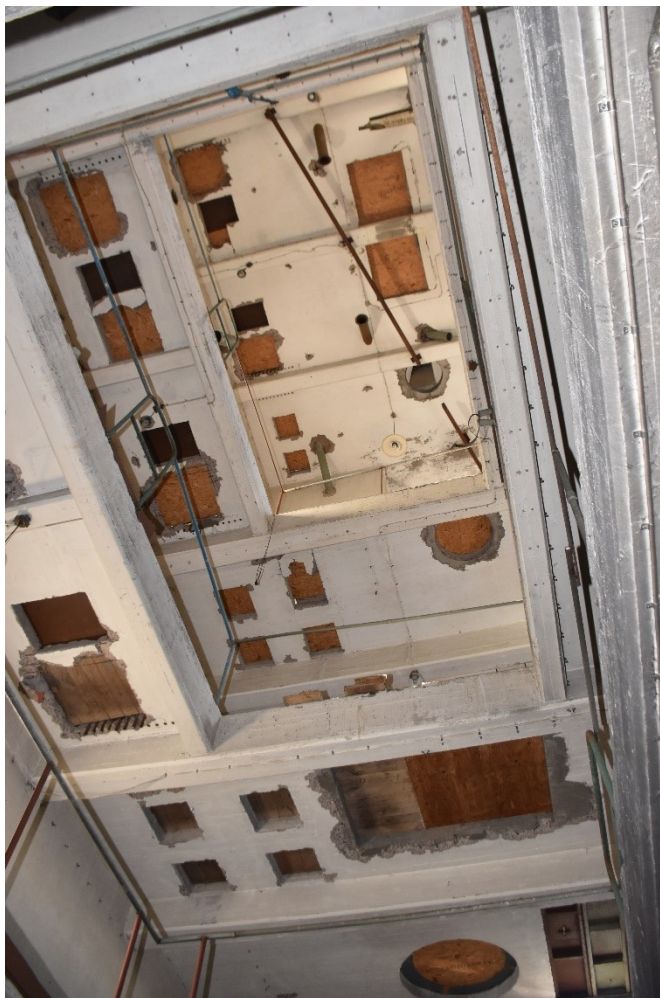
Figur 14. Bild tagen från plan två riktad uppåt i byggnaden. Alla hål som täckts med träskivor syns i samtliga plan.
