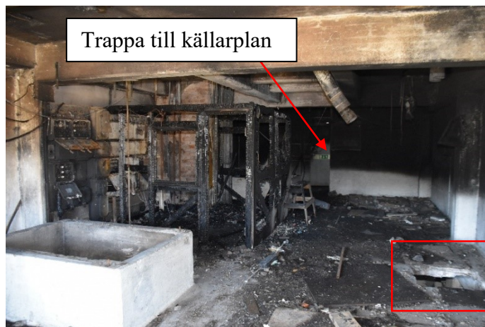
Figur 6. Bild tagen genom öppningen vid lastbryggan på det brandutsatta utrymmet i bottenplan. Det hål där brandmannen ramlat ner i är markerat med röd ram och ses till höger i bild. Hålet är 70cm x 80cm. Rummet med el-centraler som brunnit ses till vänster.
