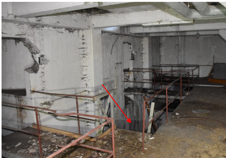
Figur 11. Övre delen av källarplan. Trätrappan ner till den nedre delen framgår av den röda pilen.
