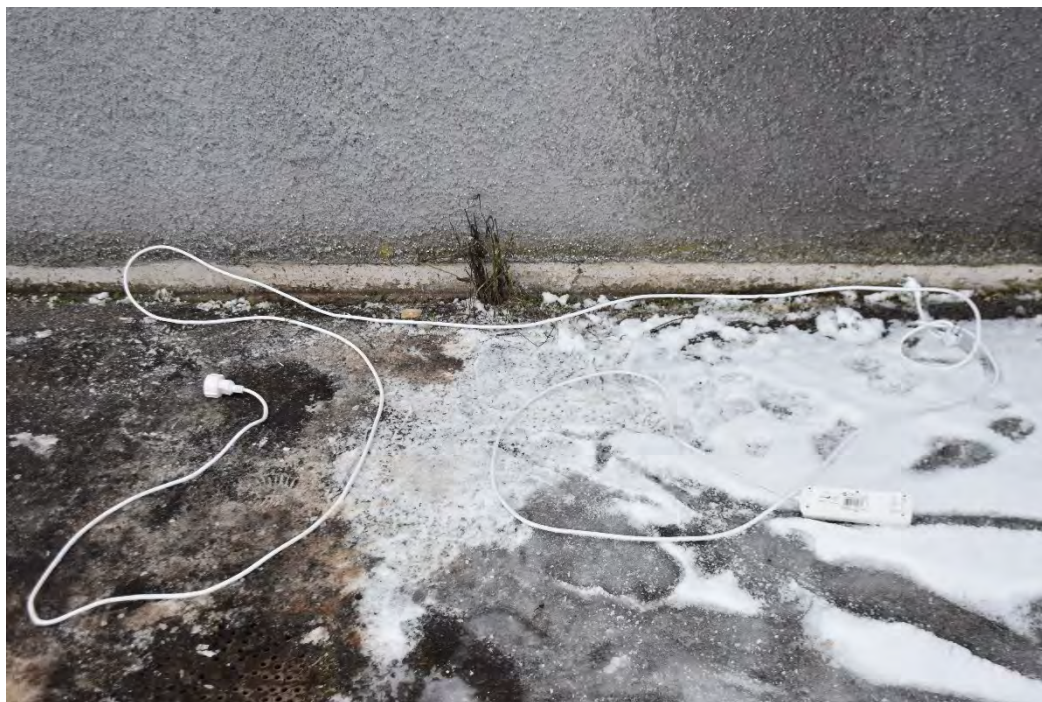
Figur 5. Den sammanbundna förlängningsladdan och fördelningsdosan.
