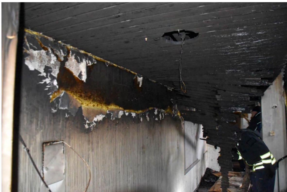
Figur 11. Brandskador i markplan i trapphus 6 C, bild tagen från korridor som sammanbinder trapphusen mot dörr till Röda Korset
