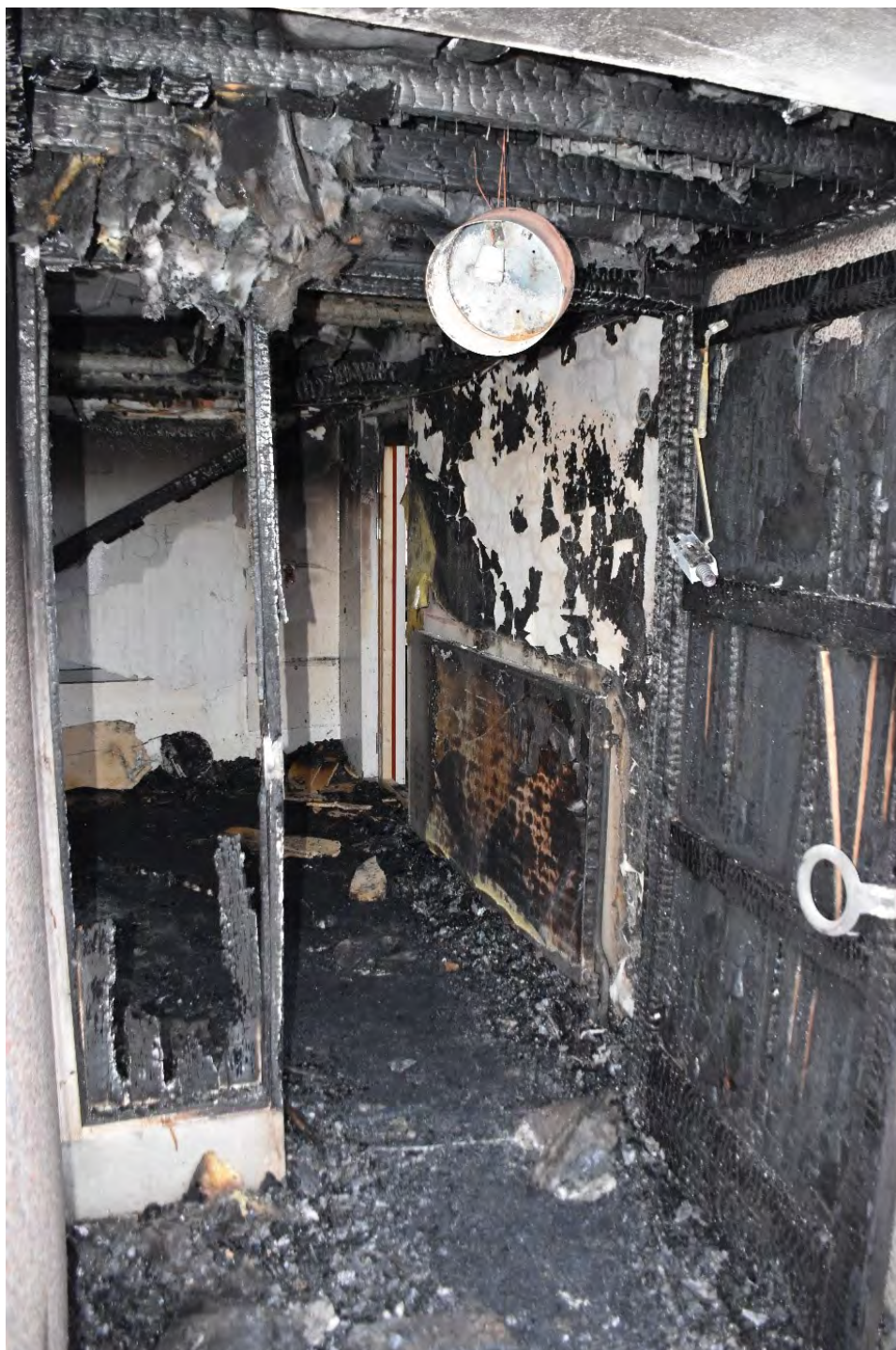
Figur 8. Brandskador på ytterdörr och i trapphall i uppgång 6 C. Dörr till Röda Korsets lokaler syns till höger i slutet på hallen.
