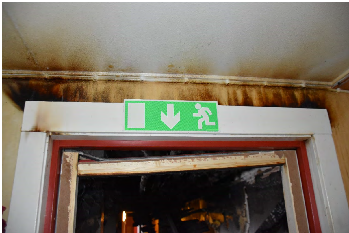
Figur 13. Dörr mellan Röda Korsets lokaler och trapphallen. Foto taget från Röda Korsets lokaler.
