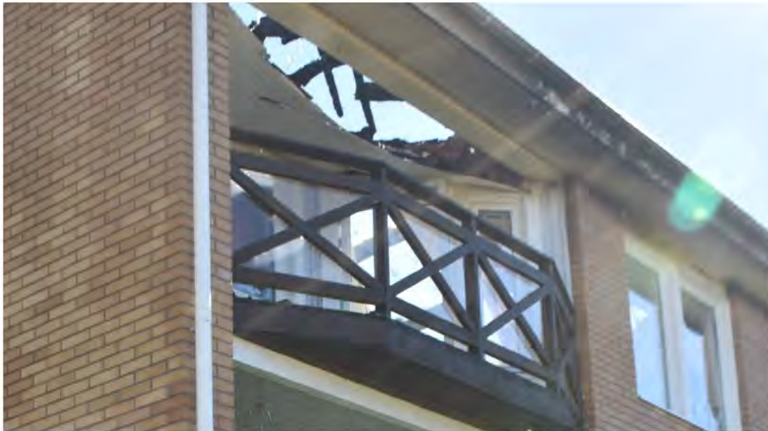
Figur 13. Bild på träpanel ovan balkonger på plan 2. På bilden har panelen delvis rasat ner.
