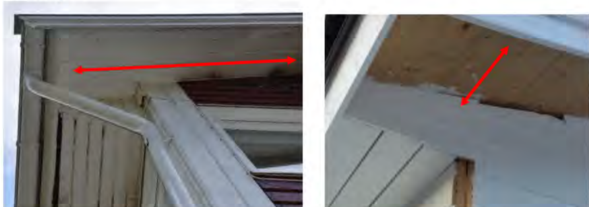
Figur 17. Panel på undersida av gaveltaksprång som kan innebära att råspons saknas. Jämförande bild med råspons där bräddorna under takfot på gaveln löper i husets längdriktning.
