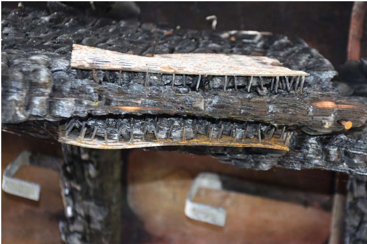
Figur 16. Exempel på spikbläck där infästningen försvagats av branden.
