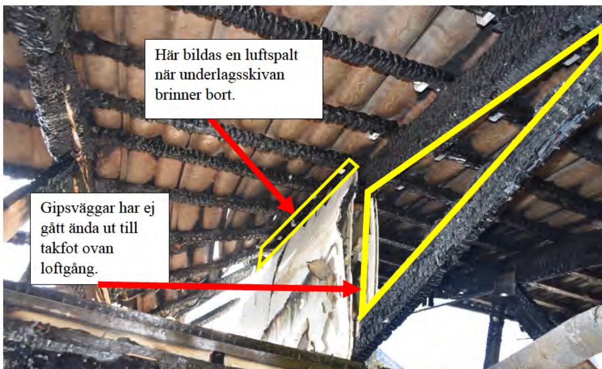
Figur 14. Bild från undersida av yttertak tagen från loftgången. Bilden beskriver två brister i brandcellsgränser på vinden som bedöms ha bidragit till en snabb brandspridning.
