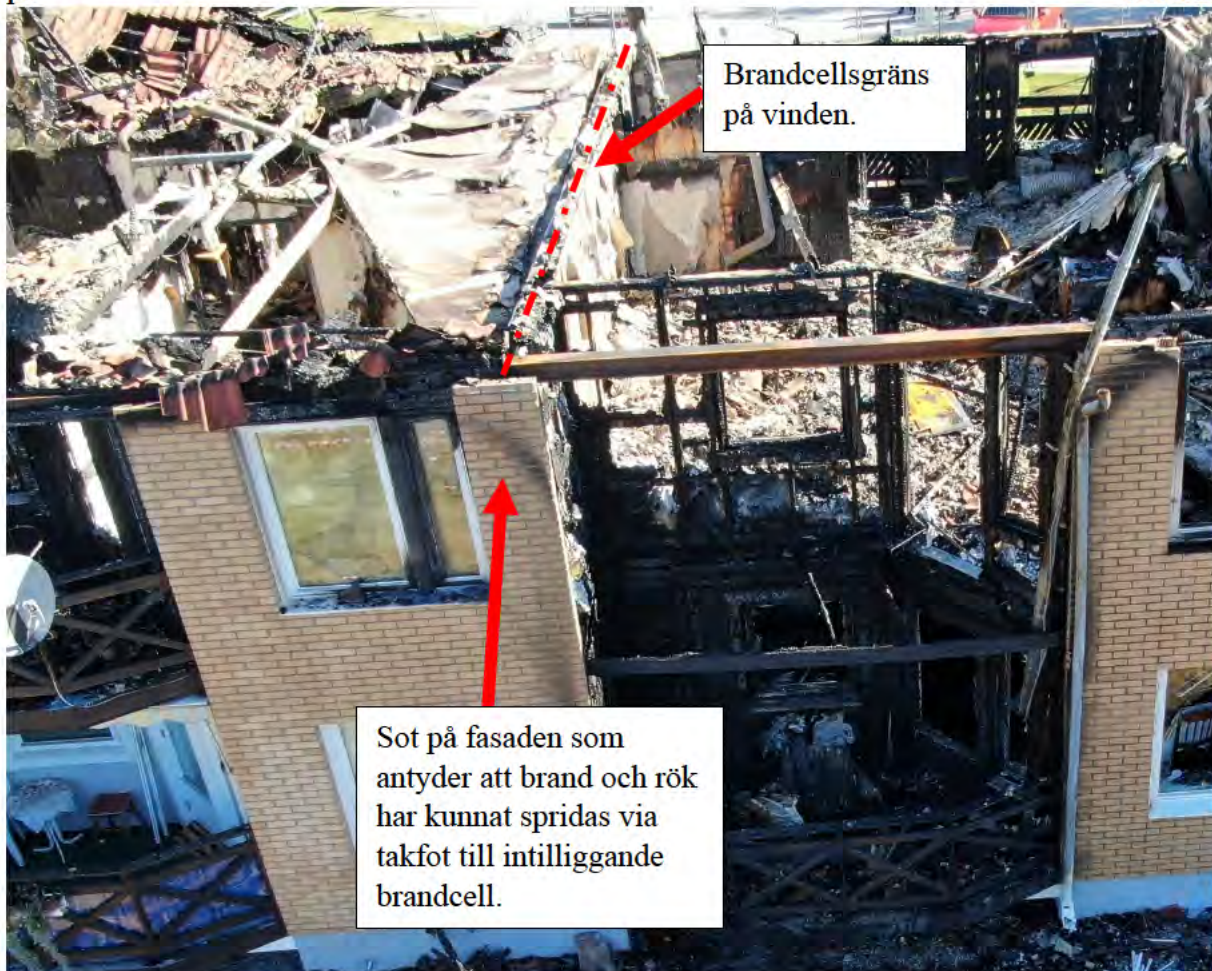
Figur 15. Bild på startlägenheten från den västra fasaden. Bilden beskriver hur branden kan ha spridits till intilliggande brandcell via takfoten.
