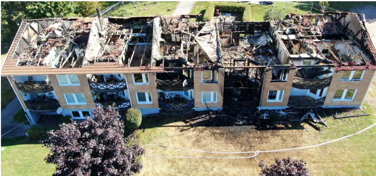
Figur 10. Bild tagen efter att räddningsinsatsen avslutats. Hela takkonstruktionen har rasat in och större delen av betongpannorna ligger på mellanbjälklaget.
